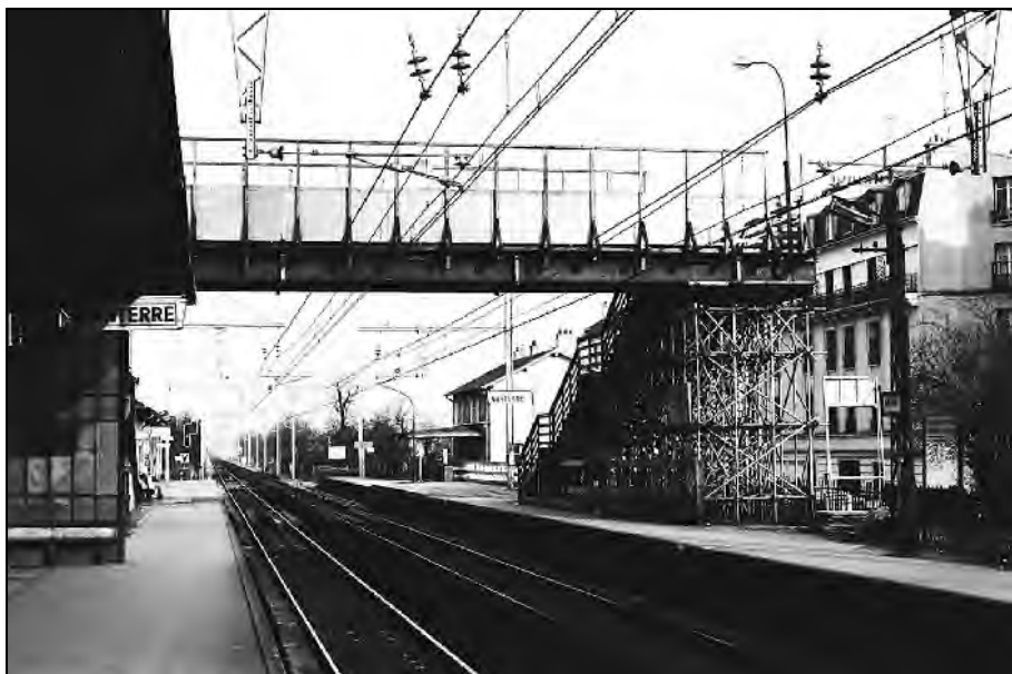
Une passerelle provisoire est réalisée au-dessus des caténaires, en attendant la construction du passage sous les voies. (Photo JRC)
