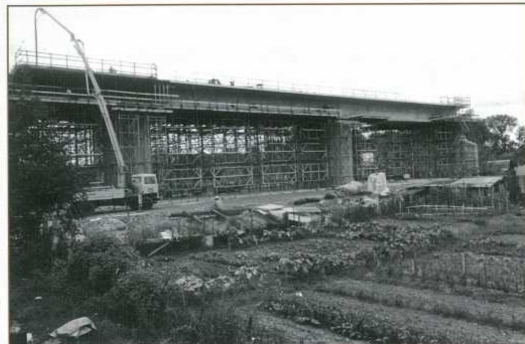
1977, construction du pont de la ligne Cergy-Pontoise et les jardins des papetiers.
